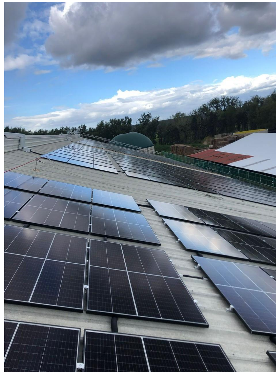
Industriebetrieb Nähe Alfeld 316 kWp
