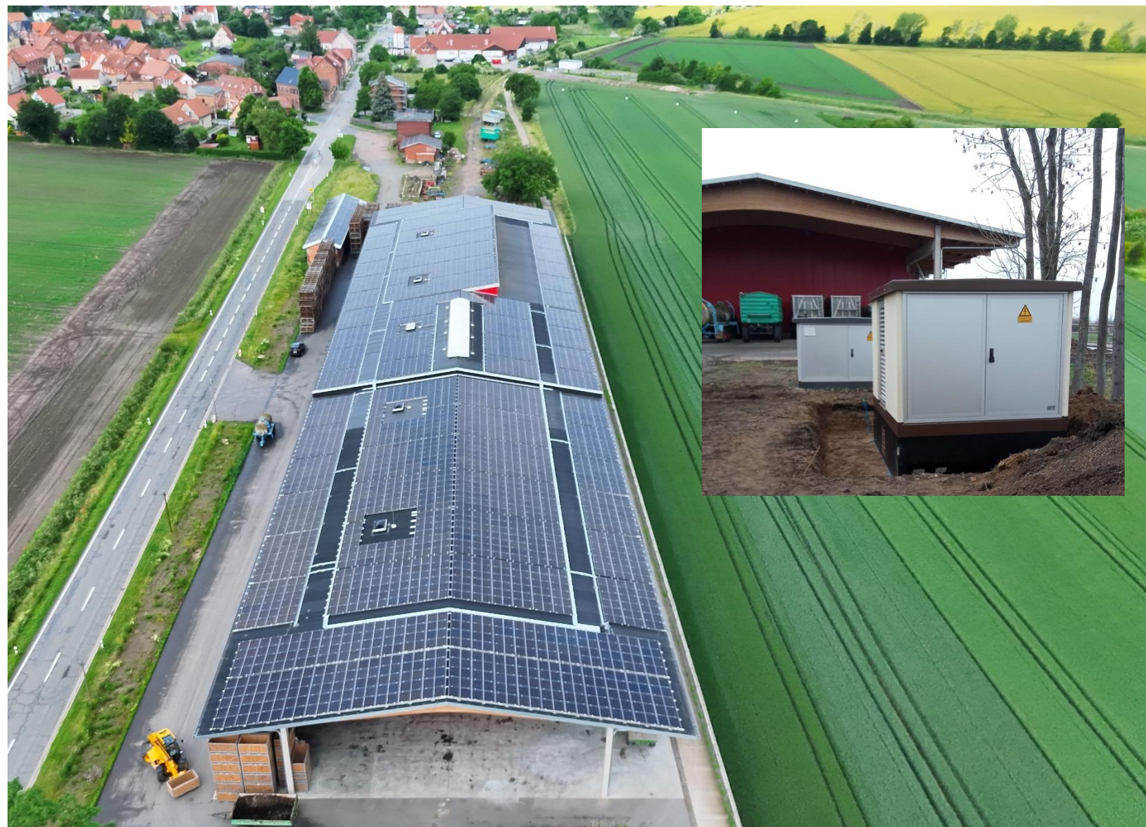
Lagerhalle in Dingelstedt 999 kWp auf 2 Dächern
