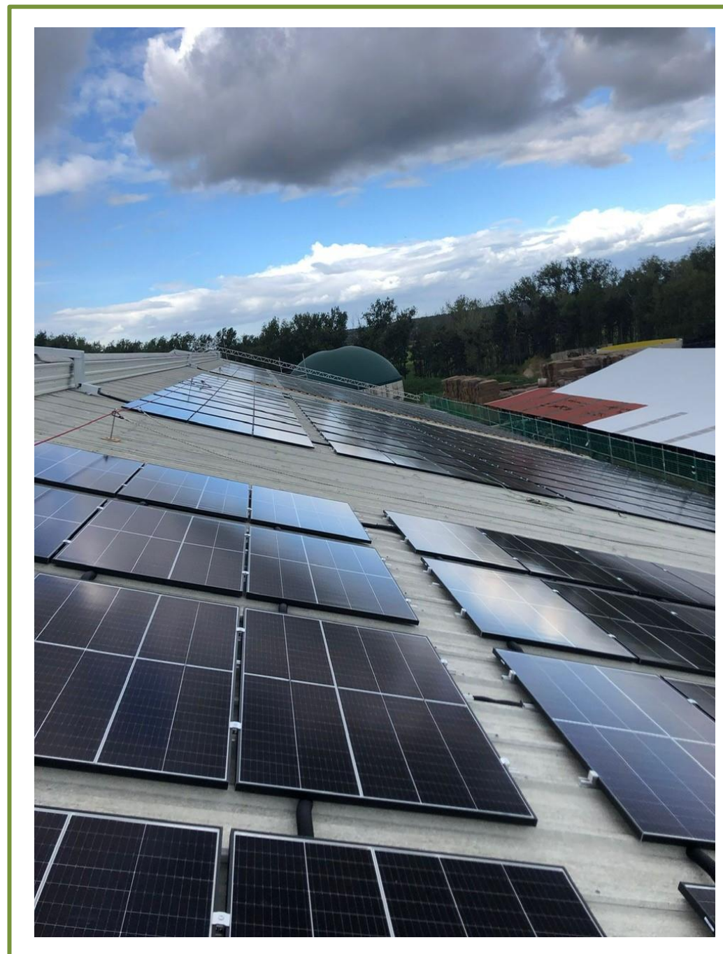
Industriebetrieb Nähe Alfeld 316 kWp
